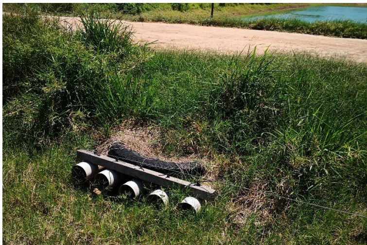
Fotografía 23. Alcantarillas de toma de agua en tajamares de sedimentación, diseñados para reducir introducción de sedimentos
