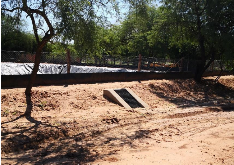
Fotografía 17. Reservorio impermeabilizado almacenamiento de agua de área de servicios (Neuland)
