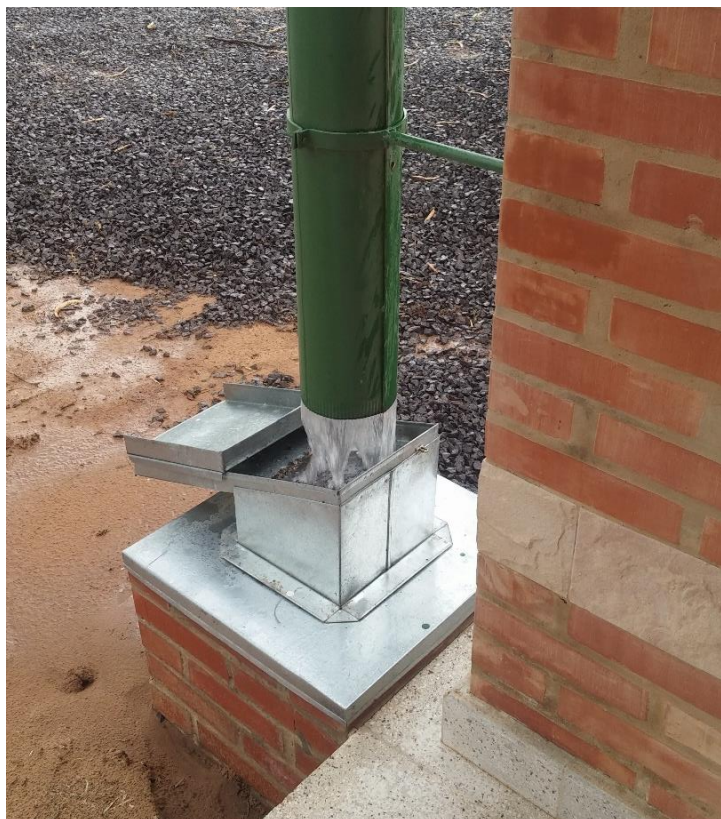
Fotografía 6. Canaletas con filtro contra insectos y otros residuos
