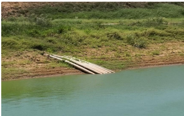
Fotografía 24. Tubos de acceso agua al tajamar principal para evitar erosión
